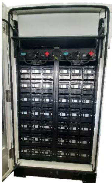
ABBILDUNG 6: ANSICHT BATTERIESEITE GEÖFFNET
