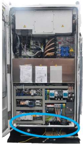
ABBILDUNG 53: SOCKELBEREICH AUF FEUCHTIGKEIT PRÜFEN (WECHSELRICHTERSEITE)
