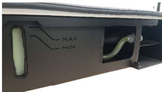
ABBILDUNG 43: FLÜSSIGKEITSSTAND DER KLIMAANLAGE
