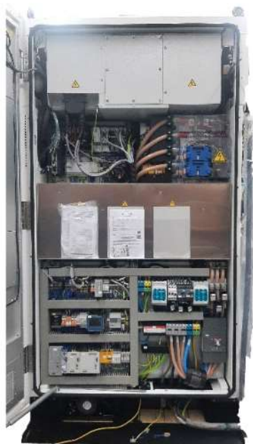
ABBILDUNG 4: ANSICHT WECHSELRICHTERSEITE GEÖFFNET
