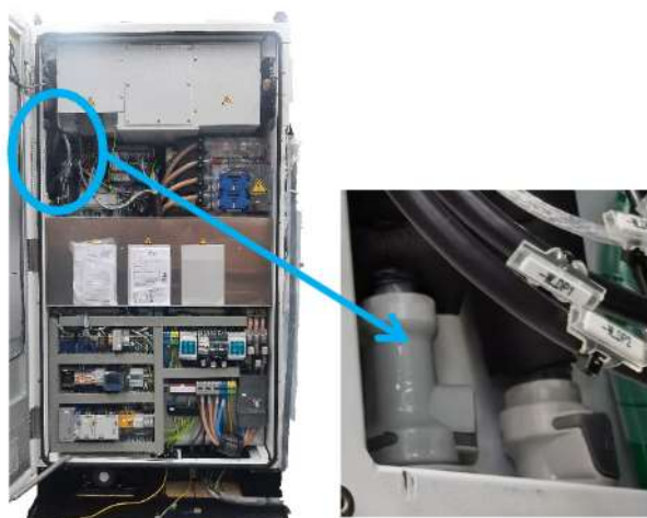
ABBILDUNG 44: KÜHLSCHLÄUCHE PRÜFEN (WECHSELRICHTERSEITE)
