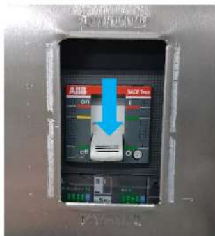
ABBILDUNG 36: HAUPTSCHALTER IN POSITION „OFF“
